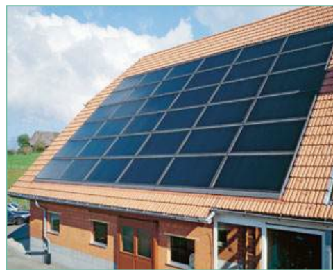
Panneaux photovoltaïques intégrés © Batirama
